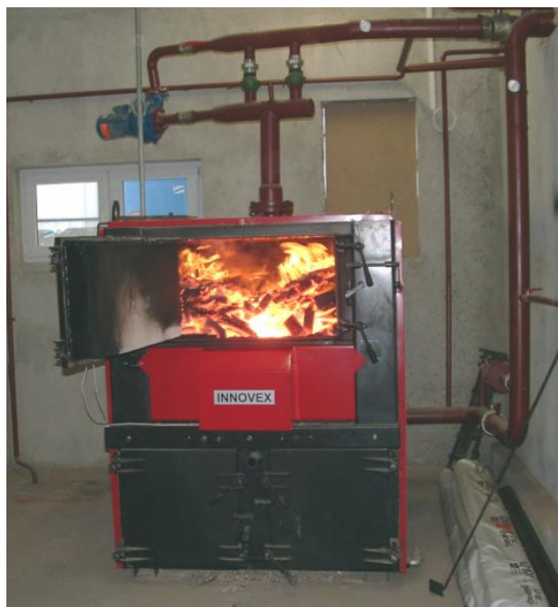
Widok komory paliwowej podczas pracy kotła
