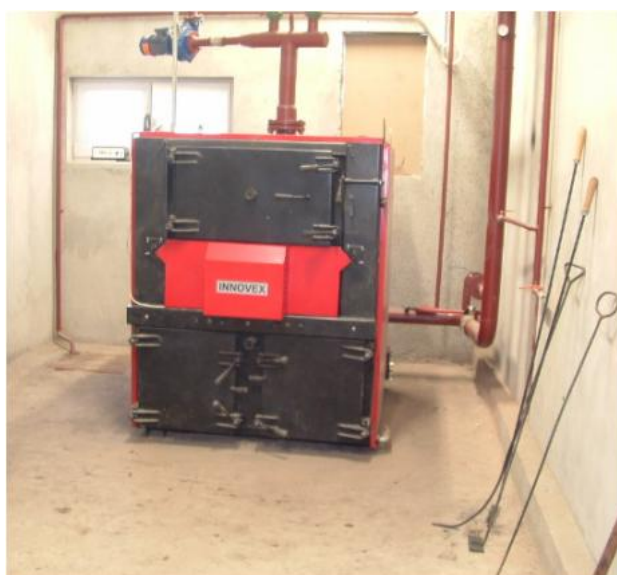
Widok kotłowni wraz z kotłem
