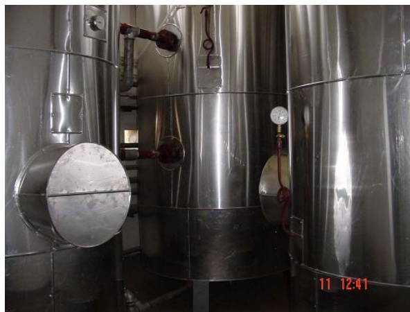
Zasobniki ciepłej wody użytkowej
