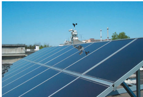
System fotowoltaiczny zainstalowany na dachu Szkoły Podstawowej nr 76 w Falenicy
