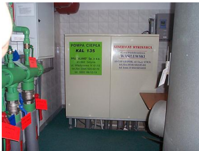
Pompa ciepła zainstalowana w Cedrach Wielkich.
