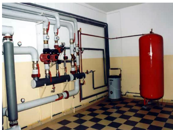
Zdj. 5. Zbiornik akumulacyjny i naczynie przeponowe
