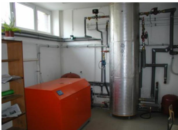
Pompa ciepła w Gimnazjum Nr 1 w Miechowie
