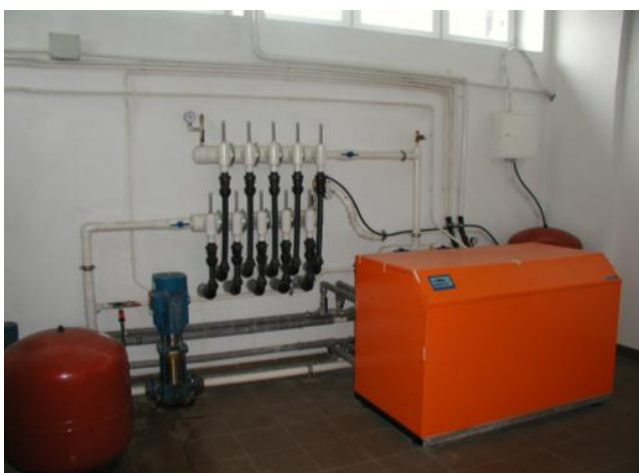
Pompa ciepła w Szkole Podstawowej Nr 2 w Miechowie
